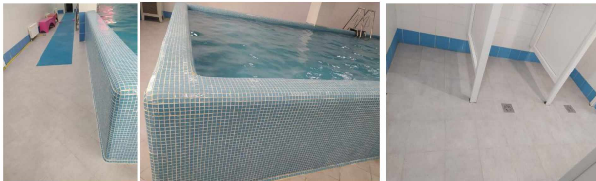
Рис. 57. Текущий ремонт по замене облицовки плитки чаши малого бассейна, затирка швов, обходной дорожки большого бассейна и душевых, замена плитки обходных дорожек, раздевалок малого бассейна СК «Сокол»
